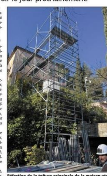
Réfection de la toiture principale de la maison-atelier de Blasco Mentor. (Photos M. R.)
